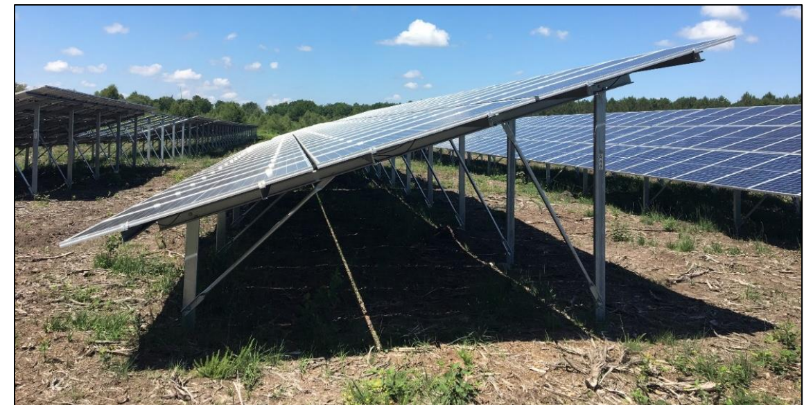
Photo 4 : Exemple de structure de tables fixes
