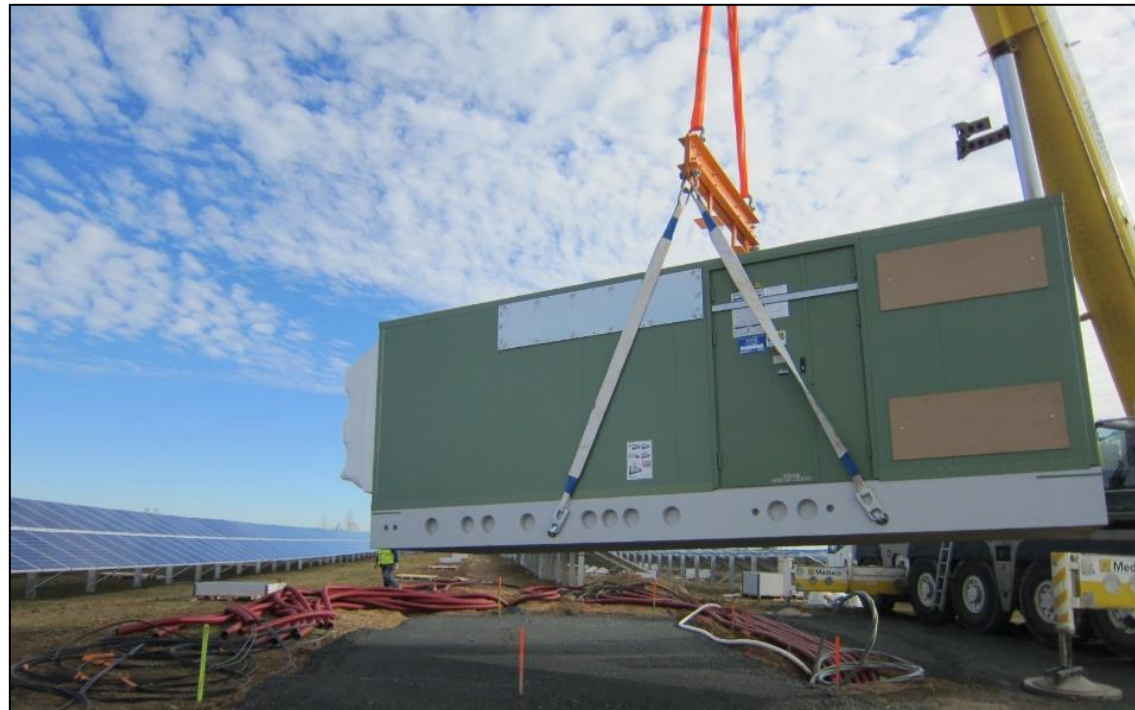
Photo 6 : Exemple d'installation de poste de conversion
