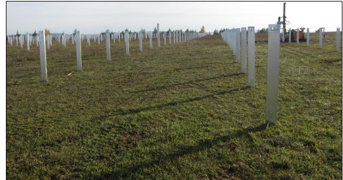
Photo 3 : Exemple de pieux battus dans le sol avec une batteuse visible en arrière-plan
